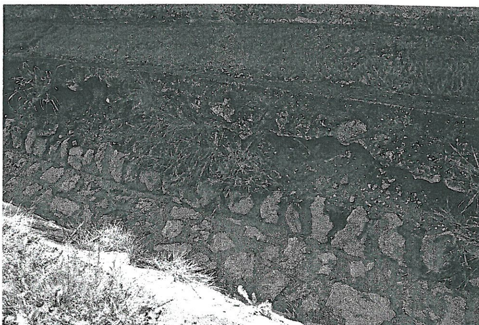
Erősen károsodott partfal
