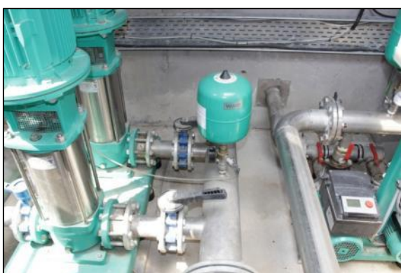
Tűzivíz vízigényt biztosító szivattyúpár
