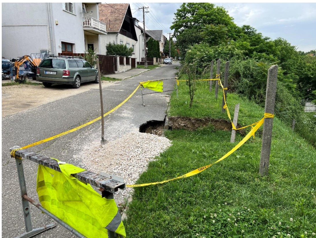
1. kép – Kálvária utca 35. sz ingatlan előtti suvadás (316/1 hrsz.)
