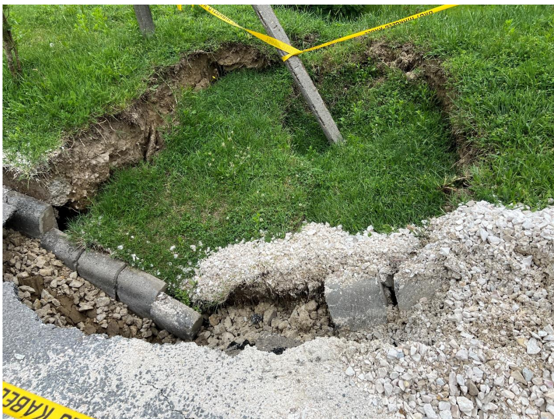
4. kép – Kálvária utca 35. sz ingatlan előtti suvadás, leszakadt útszegély (316/1 hrsz.)
