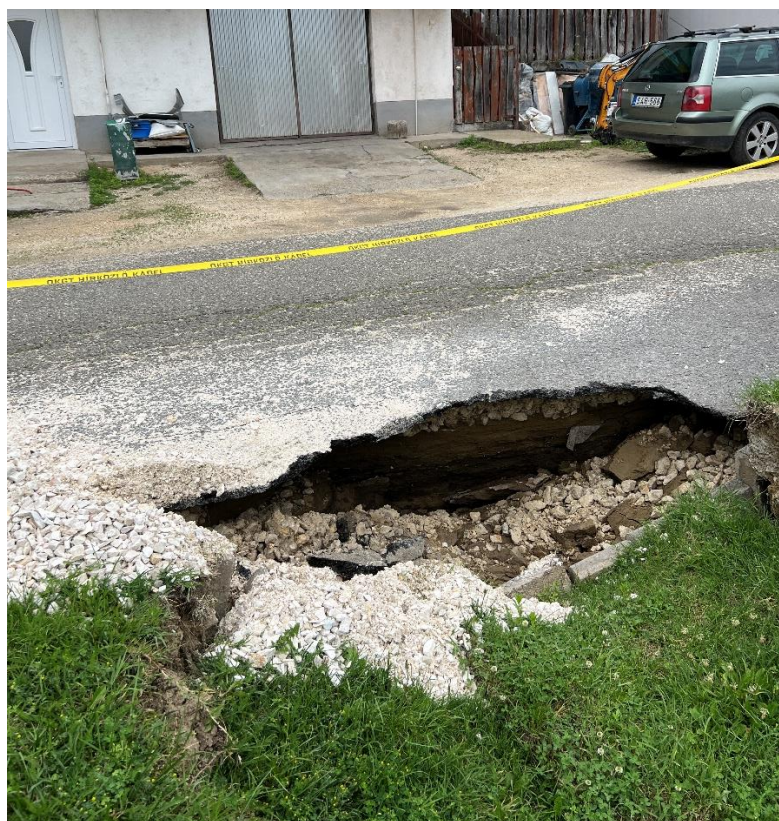
6. kép – Kálvária utca 35. sz ingatlan előtti suvadás, aláüregelődött útburkolat (316/1 hrsz.)
