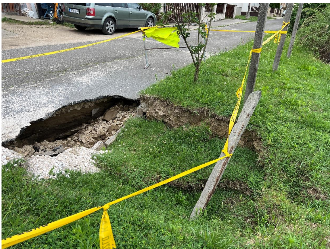
3. kép – Kálvária utca 35. sz ingatlan előtti suvadás, leszakadt útburkolat (316/1 hrsz.)
