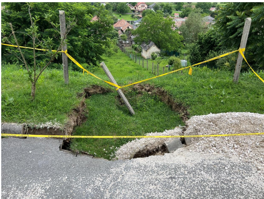
5. kép – Kálvária utca 35. sz ingatlan előtti suvadás, kidőlt kerítésoszlop
